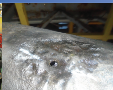
DANO MECÂNICO, AMASSADO, TRINCA, SABOTAGEM
